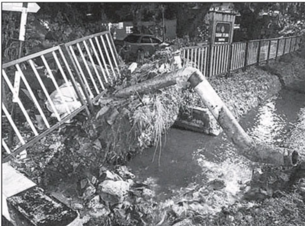
万津德里玛花园输水管遭大树压破。
